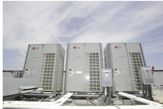
Hệ thống điều hòa không khí VRF tích hợp bộ lọc không khí và lắp đặt chính xác để kiểm soát lưu lượng không khí và nhiệt độ.
