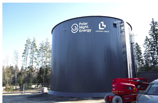
Hệ thống Pin cát Polar Night Energy mới được lắp đặt tại Pornainen, một thành phố nhỏ ở miền nam Phần Lan (Nguồn: Polar Night Energy).
