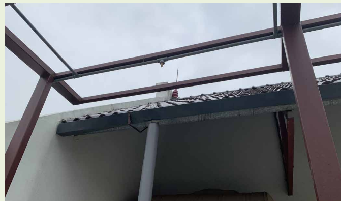
Thu nước mưa từ mái về bể chứa
