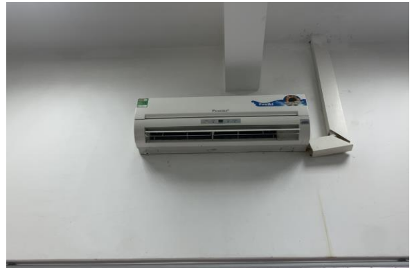
Điều hòa không khí
