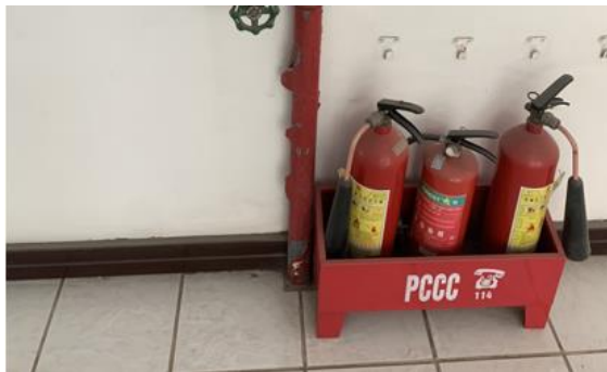
Bình chữa cháy
