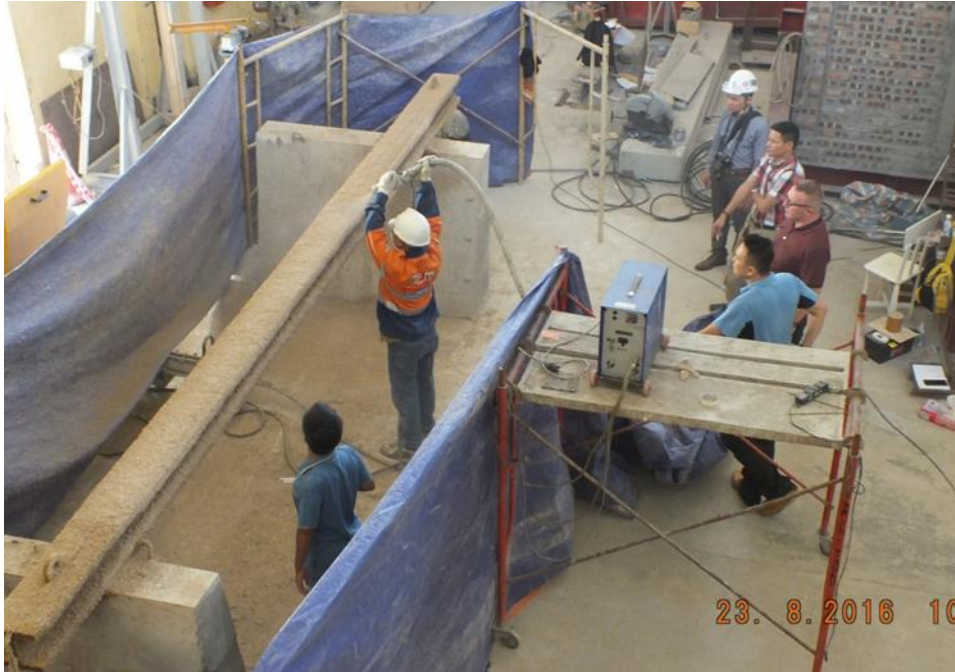
Hình 25 – Ví dụ thi công phun bọc bảo vệ chịu lửa cho dầm thép bằng vữa
