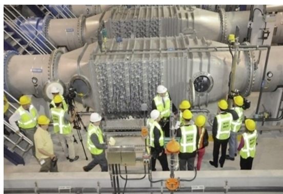
Hệ thống khử trùng nước của New York.
