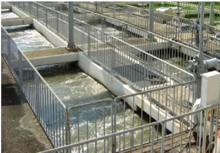
Ảnh 2: Bể Aeration tại trạm XLNT Hirano
