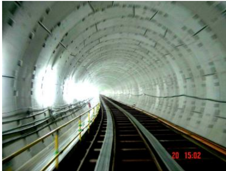
Ảnh 1. Đường hầm thoát nước Yodo Grand Floodway, T.P Osaka
