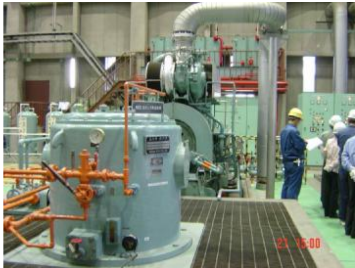
Ảnh 2: Buồng bơm tại trạm bơm Suminoe, Osaka Port.
